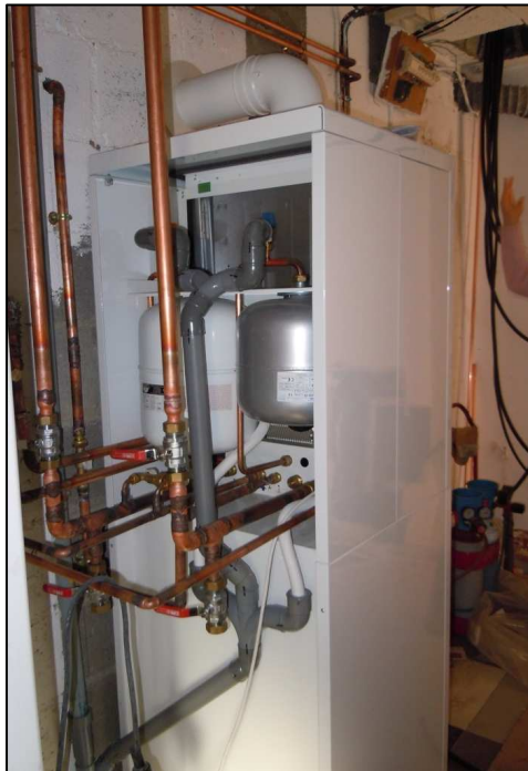
Chaudière à condensation
